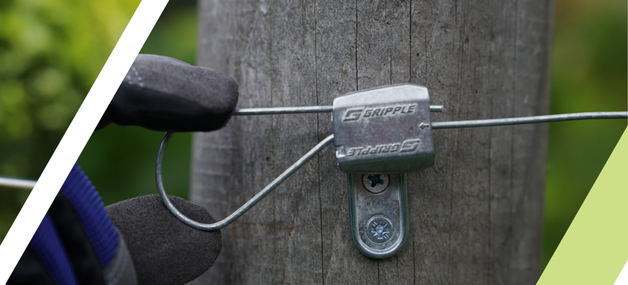
Vit S - Instalado en postes de madera
