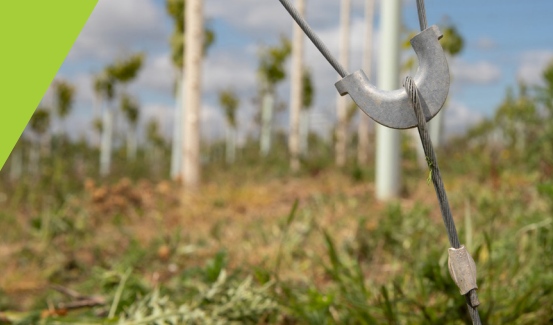
GPAK Plus W instalado nos postes de madeira
